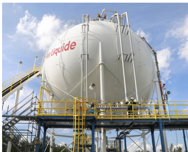
エアリキードはカナダのベカンクールに世界最大の PEM 電解装置を建設 写真提供: エアリキード
